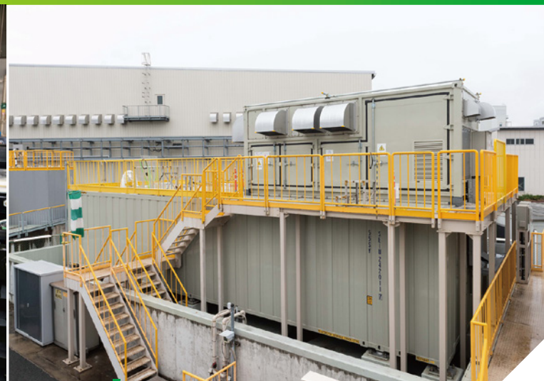
実証用の新型RF電池（住友電気 大阪製作所内）。
