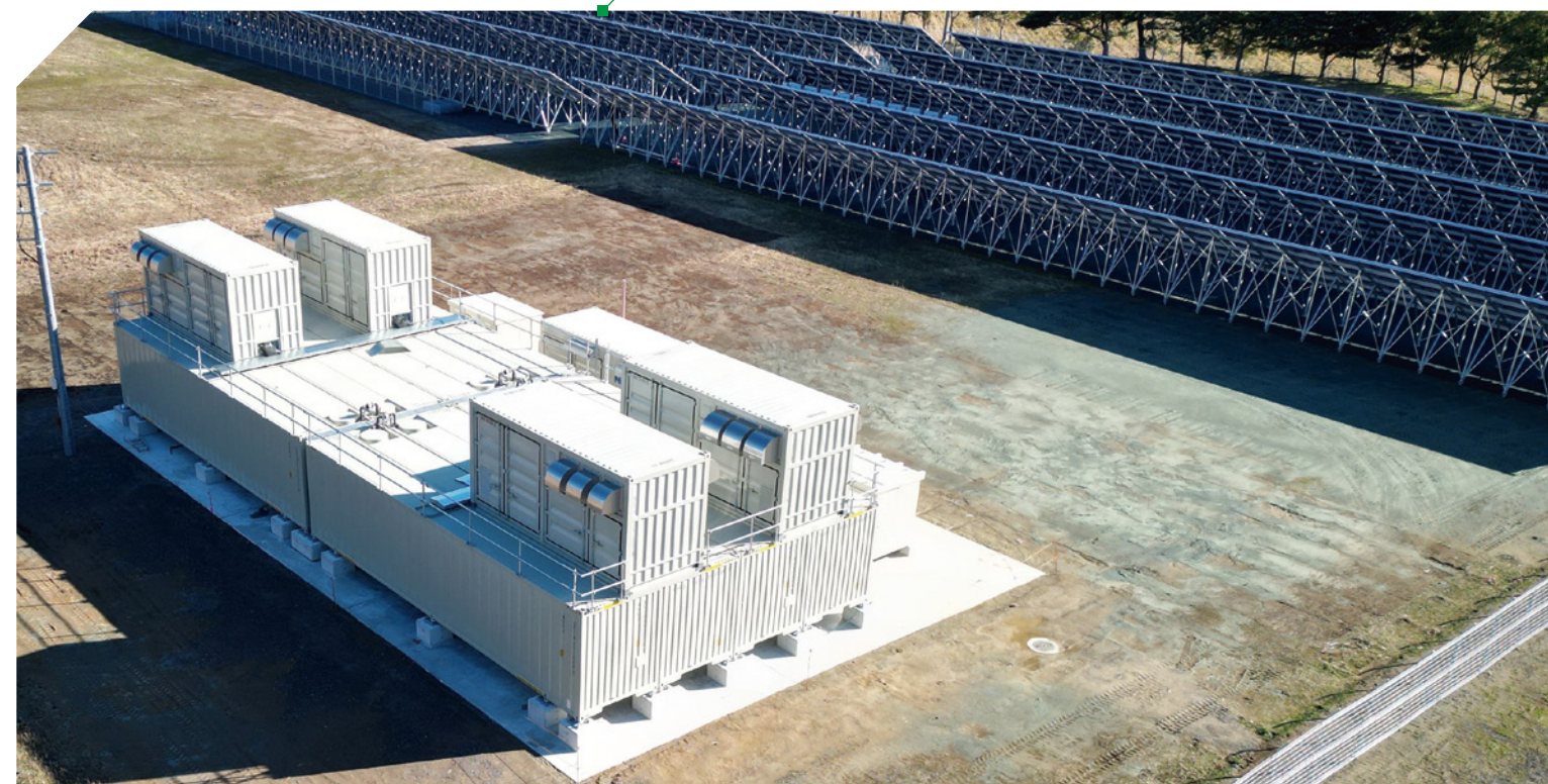
地域新電力会社向け系統用蓄電池として新潟県柏崎市に導入されたレドックスフロー電池と太陽光パネル。出力1,000kW、容量8,000kWhの大規模設備で、国内最長クラスとなる約8時間の放電が可能。
